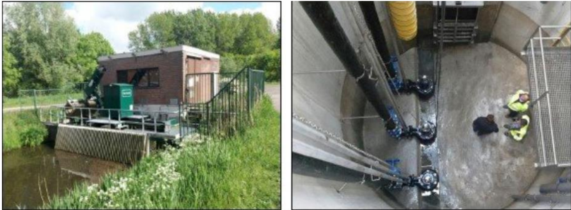
Figuur 57: Pompgemaal in polder van Sinaai-Daknam. Bron: VVWP.
